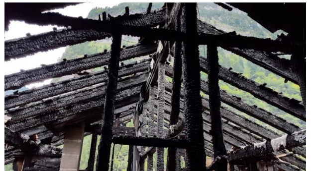
Abbildung 2: Haus nach den Löscharbeiten (Foto: Robert Imhof 2015).
