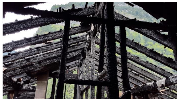
Abbildung 2: Haus nach den Löscharbeiten (Foto: Robert Imhof 2015).
